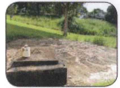
Mantenga el pozo séptico sellado.
